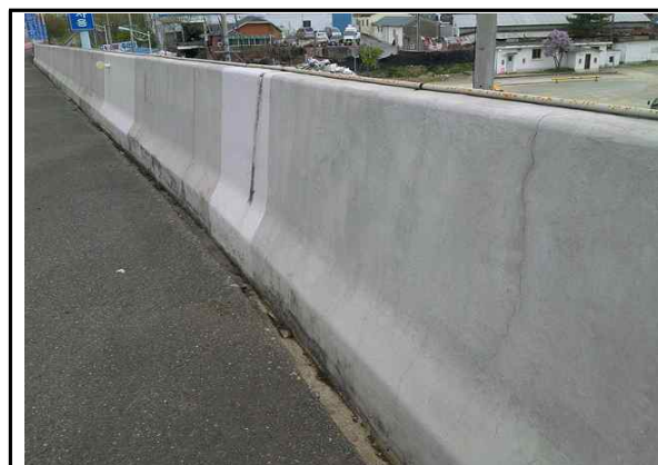
S1 방호벽 균열(폭 0.2mm)
