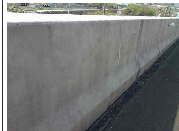
S2 방호벽 균열(폭 0.2mm)
