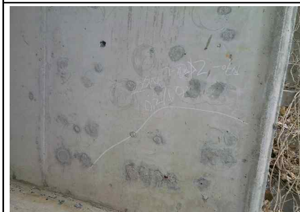
A2 홍벽 균열(폭 0.2mm)
