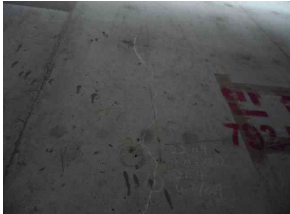
P1 코핑부 균열(폭 0.2mm)
