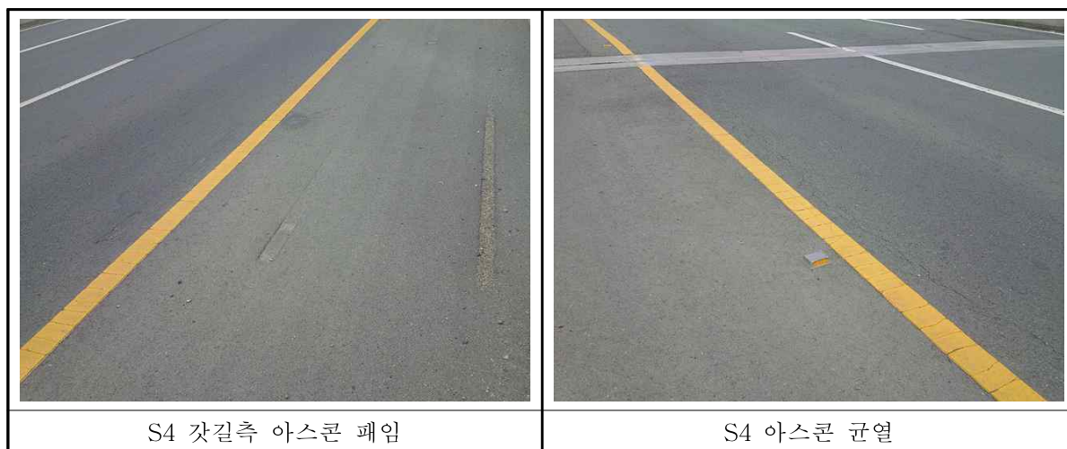
&lt;표 3.22&gt; 범물방향 교면포장 외관조사 결과
