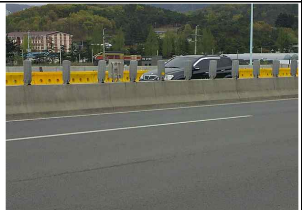
S3 중앙분리대 균열(폭 0.2mm)
