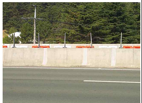
S2 중앙분리대 균열(폭 0.1mm)
