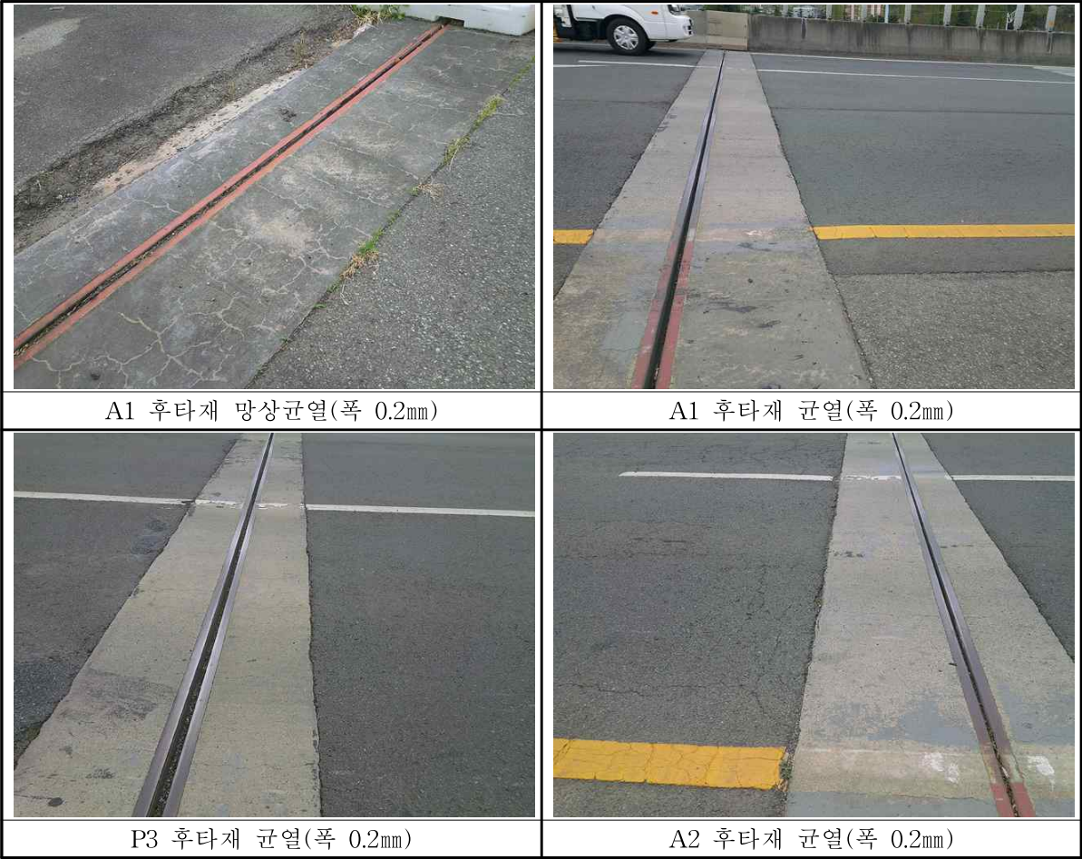
<표 3.17> 범물방향 신축이음 외관조사 결과
