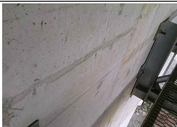
P4 코핑부 균열(폭 0.2mm)
