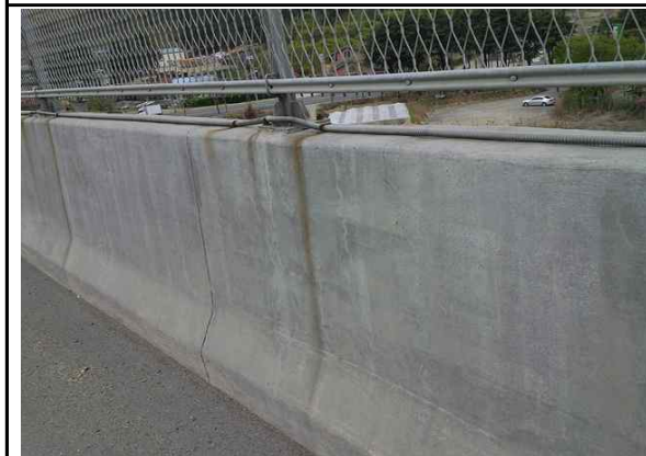
S4 방호벽 균열(폭 0.2mm)
