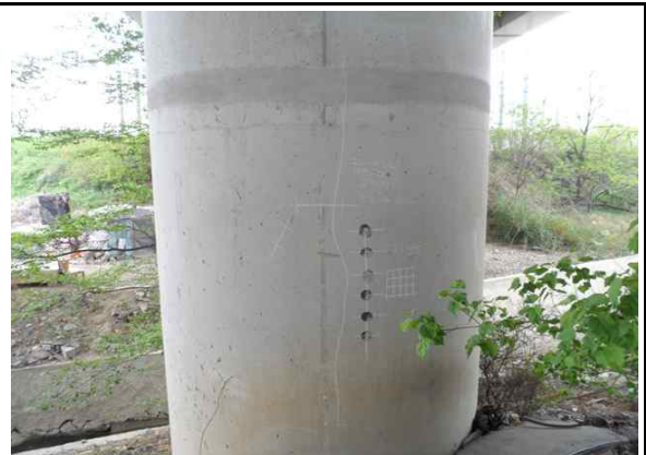
P3 기둥부 균열(폭 0.2mm)
