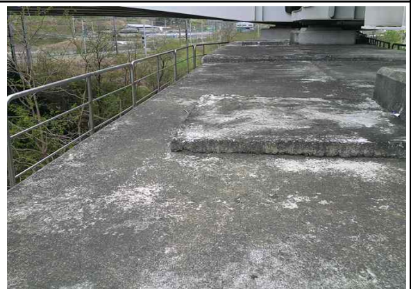
P3 코핑부 표면열화, 체수흔적
