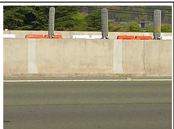
S1 중앙분리대 균열(폭 0.1mm)
