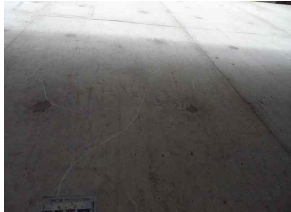
P1 코핑부 균열(폭 0.2mm)
