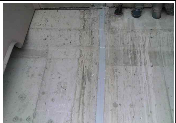
A2 실란트 보수 - 양호
