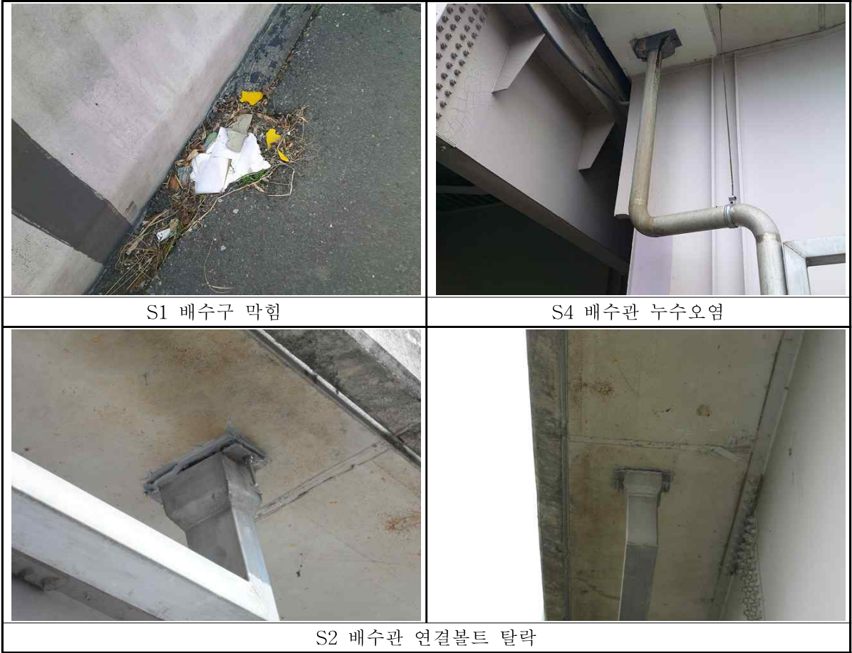
<표 3.54> 안심방향 배수시설 외관조사 결과
