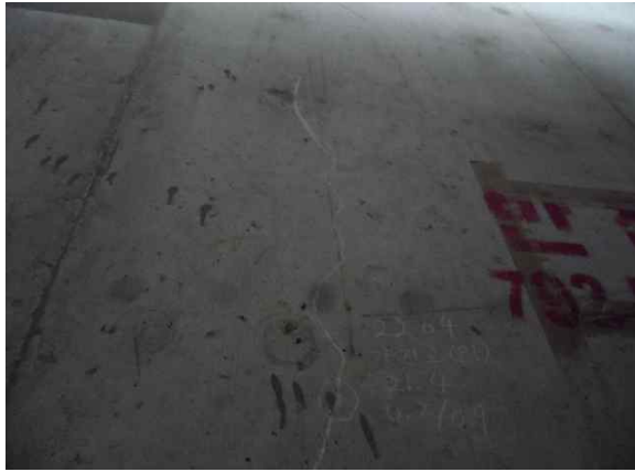
P1 코핑부 균열(폭 0.2mm)
