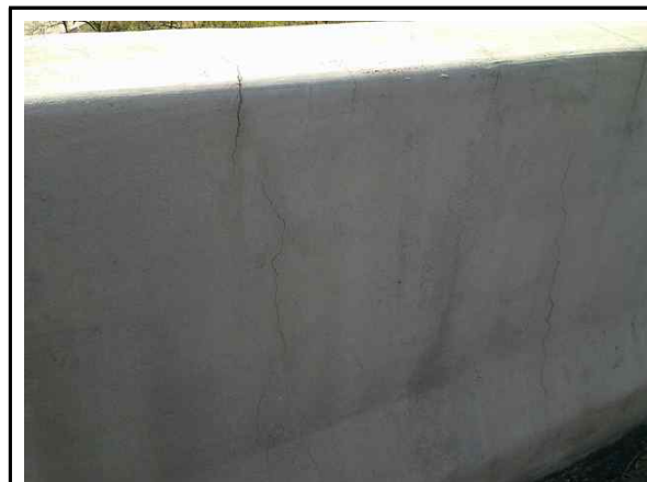
S1 방호벽 균열(폭 0.2mm)
