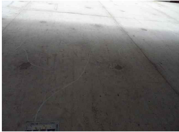
P1 코핑부 균열(폭 0.2mm)
