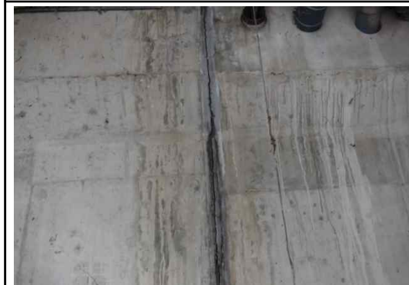
A2 실란트 파손(21년 정밀안전점검)
