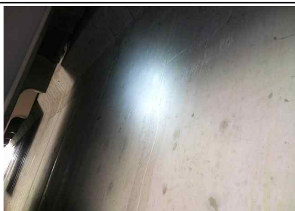
A2 홍벽 균열(폭 0.2mm)
