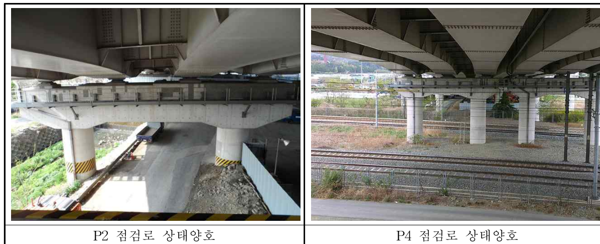
<표 3.58> 안심방향 점검시설 외관조사 결과
